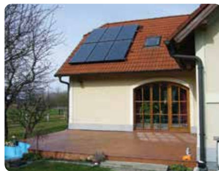
Systém ohřevu teplé vody a bazénu, regenerace vrtů tepelného čerpadla, 6 ks plochých vakuových TS 400.
