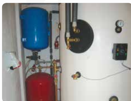
Ohřev akumulční nádrže PS2F 1000 pro přitápění a ohřev teplé vody.
