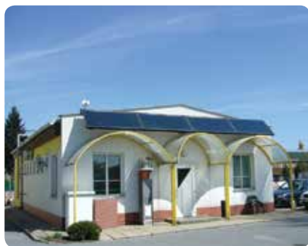
Systém ohřevu teplé užitkové vody SCHIEDEL – provozovna Olomouc, 4 ks TS 330/M a zásobník RGC 400.
