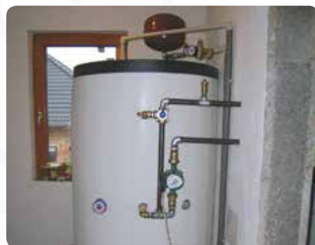
Akumulční nádrž pro přitápění a ohřev teplé vody DUOE 750/200.
