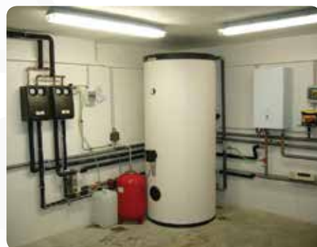
Ohřev teplé vody v zásobníku R2BC 1000 a temperování v zimním období – rekreační zařízení Doubí u Třeboně.
